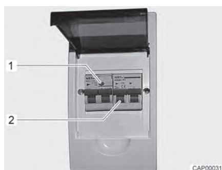
Afb. 90 230-V-zekeringenkast met beveiligingsautomaat en FI-schakelaar
